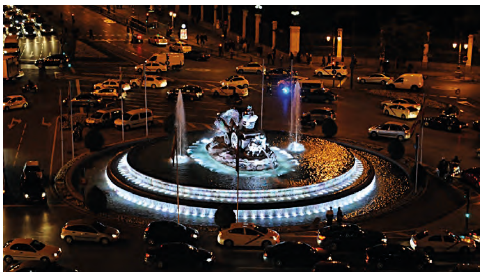
Figura 5. Nueva Instalación de Iluminación con LED. Fuente: Felipe Nombela.
