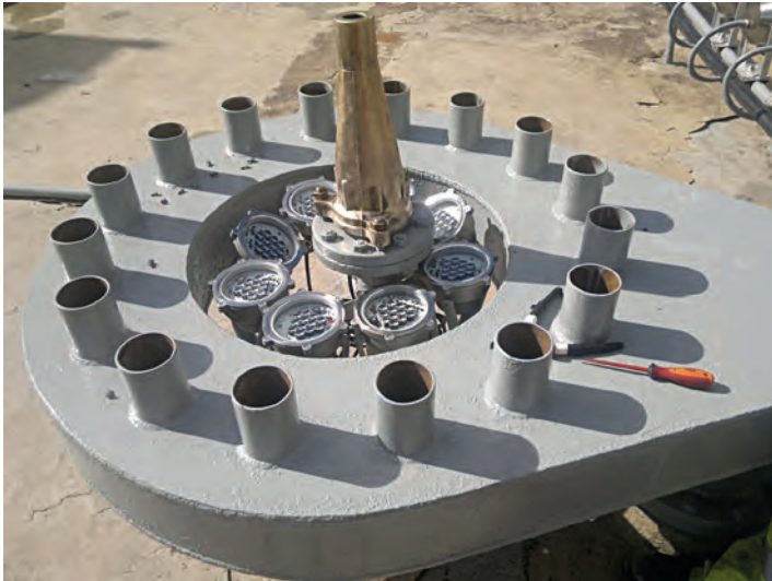
Figura 3. Montaje de proyectores LED en el surtidor de la fuente. Fuente: empresa IMESAPI, S.A.
