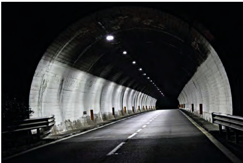
Figura 12. Iluminación de túneles.
