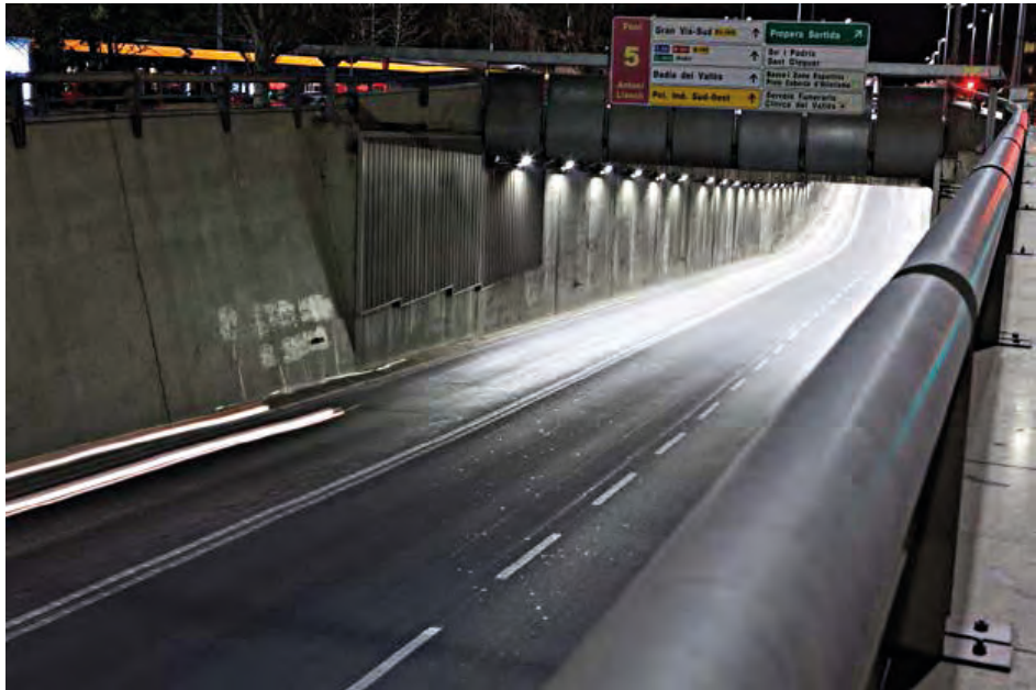
Figura 11. Iluminación de túneles.
