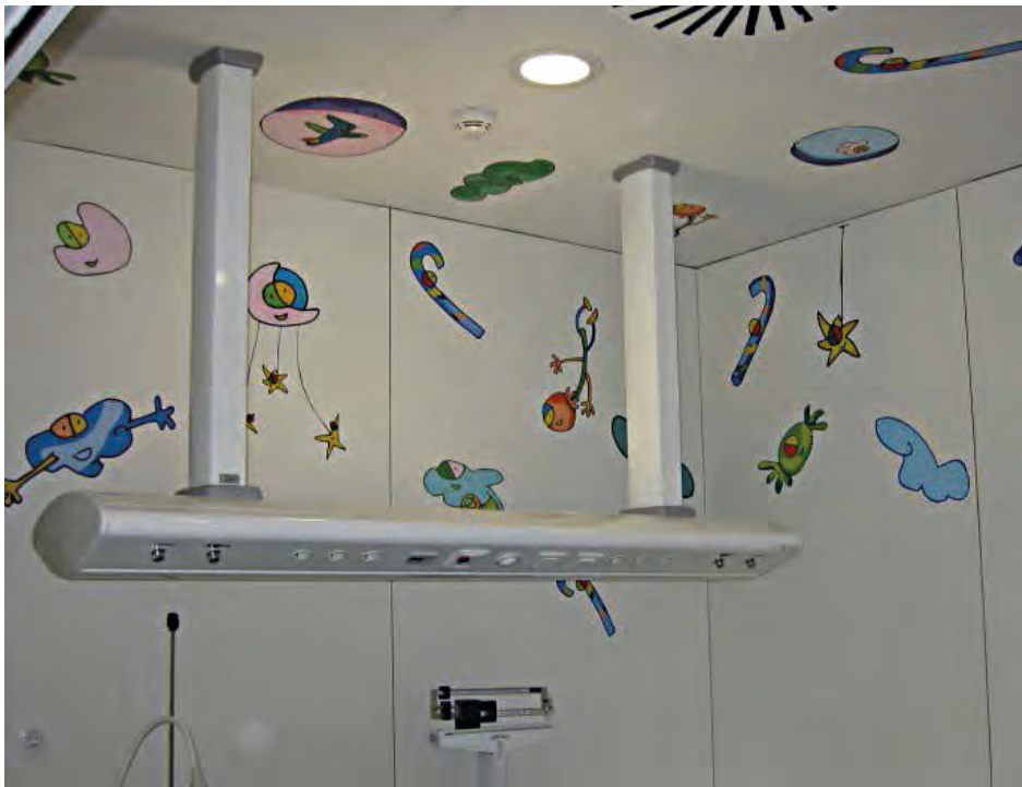
Figura 28. Iluminación en un hospital infantil.
