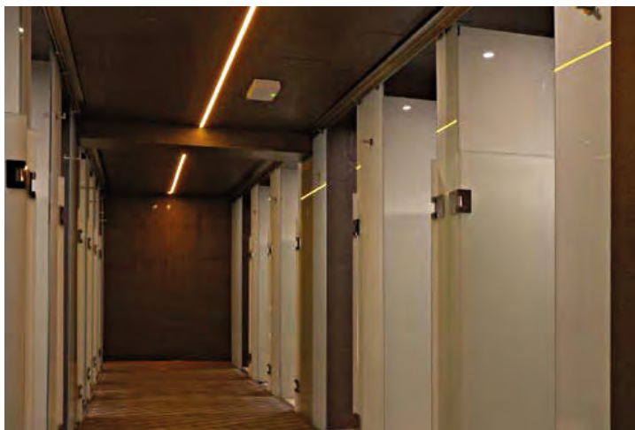
Figura 33. Ejemplo de iluminación de emergencia con LED.
