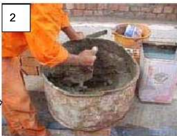
2 La mezcla de arena y cemento debe hacerse en seco. Luego esta mezcla se coloca en el recipiente para agregar el agua y lograr una mezcla trabajable.
