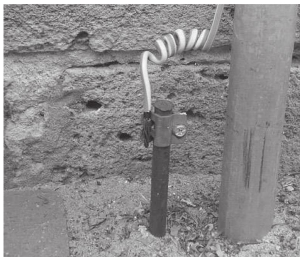
Imagen del conductor de protección, conectado a la jabalina de puesta a tierra.
