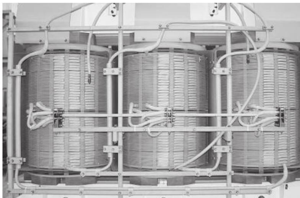
La imagen muestra el conjunto de bobinas montadas en las columnas del núcleo para el caso de un transformador trifásico, y se observan sus conexiones internas.
