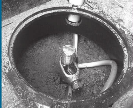
Detalle de las jabalinas de puesta a tierra de cobre, los accesorios de alargue y los accesorios de conexión.
