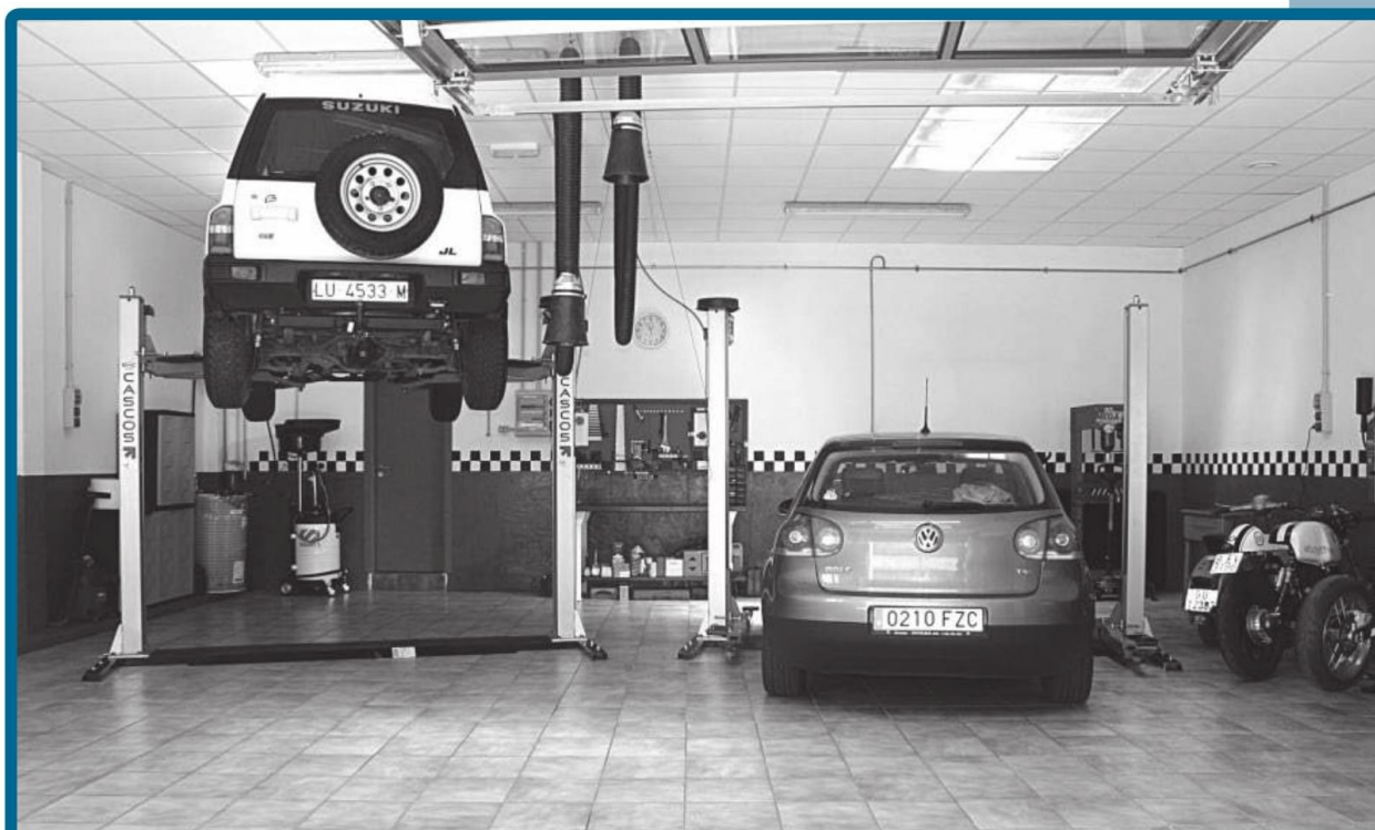
Taller mecánico de automóviles. Se pueden apreciar las instalaciones eléctricas por encima de 1,5 m y en cañería de hierro.
