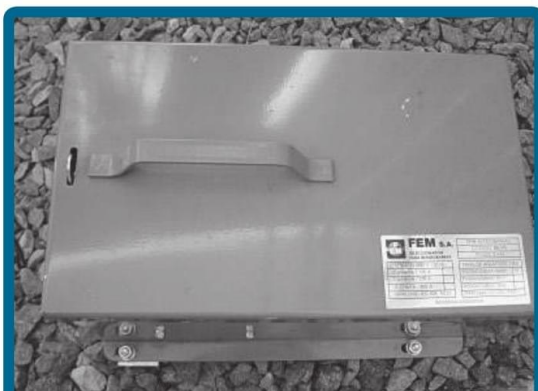
En esta imagen podemos apreciar un seccionador de blindobarras.
