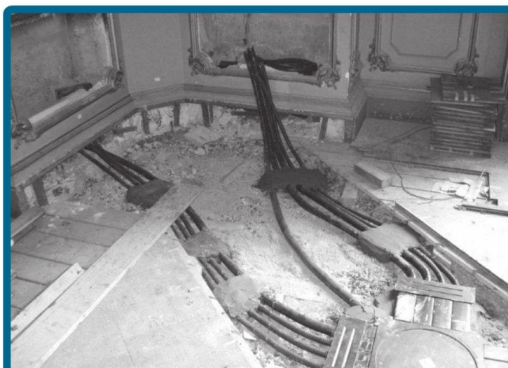
Punto de enlace entre un piso ducto y las instalaciones embutidas en las paredes.
