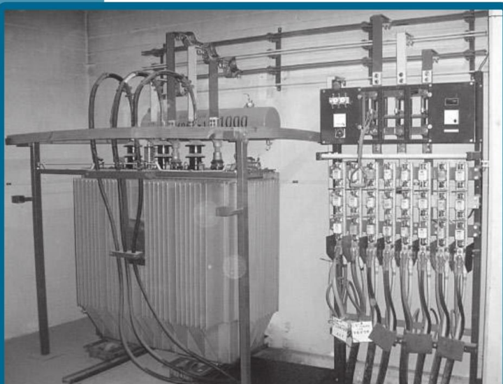
Cámara subterránea de transformación y tablero de distribución a la derecha del transformador, con salida de ocho líneas de distribución en baja tensión.
