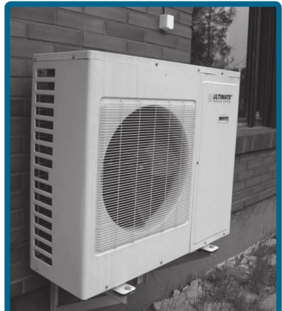
Acondicionadores de aire, otro claro ejemplo de elementos alimentados desde circuitos TUE.
