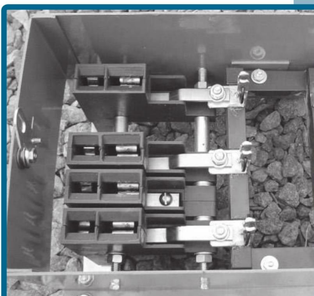
Aquí vemos el interior de un seccionador de blindobarras.
