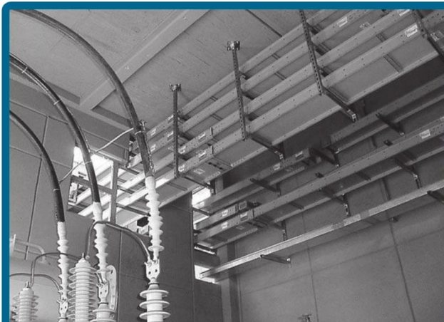
Instalación de blindobarras en una sala de transformadores.
