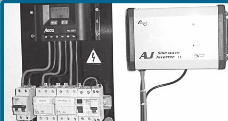
Paso 6: instalación de luminarias y equipos. Verificado el sistema con la batería a plena carga, se conectan los dispositivos.
