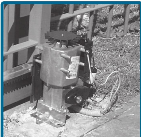
Detalle en la automatización de un portón corredizo donde se observa la ubicación de la carcasa del motor y parte de la cremallera.
