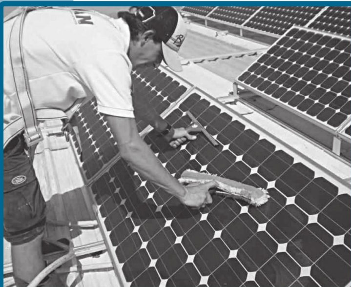
Se recomienda verificar la limpieza de los módulos fotovoltaicos limpiándolos con regularidad, verificar la orientación, el ajuste y fijación.
