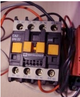
Fig. N° 43 Disyuntor o Contactor
