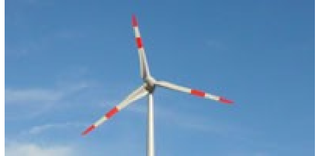
Fig. Nº 34: a) Central Eólica
